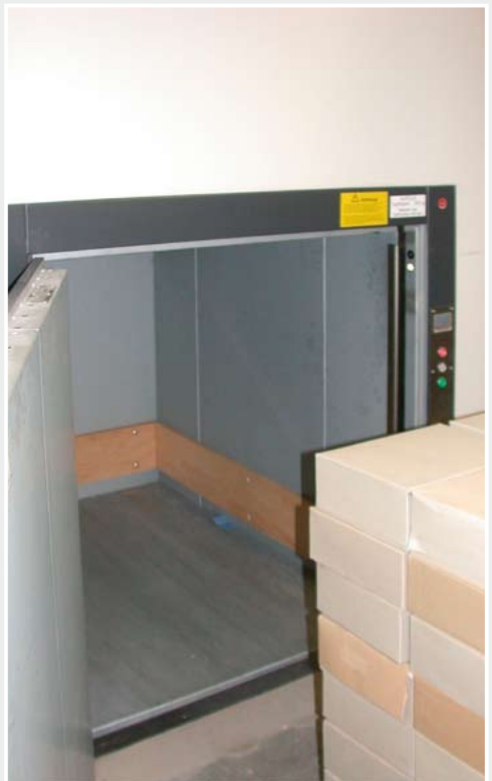
...Kabine mit umlaufendem Rammschutz
